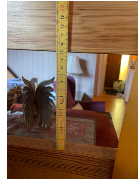
Åpning i rekkverk mellom stue og kjøkken over 10 cm
