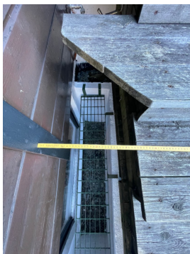
Utvendig trapp ned til terrasse mangler rekkverk/sikring
