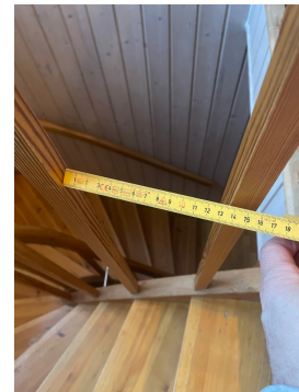
Åpning rekkverk trapp til kjeller over 10 cm
