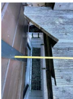
Utvendig trapp ned til terrasse mangler rekkverk/sikring
