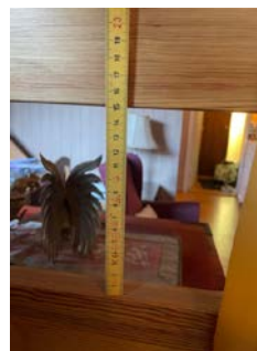
Åpning i rekkverk mellom stue og kjøkken over 10 cm
