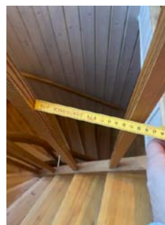
Åpning rekkverk trapp til kjeller over 10 cm
