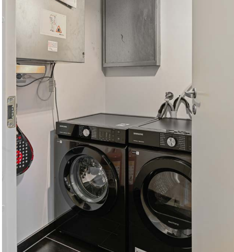
Vaskerom/teknisk rom med flis på gulv, opplegg til vask og tørk og balansert ventilasjon.
