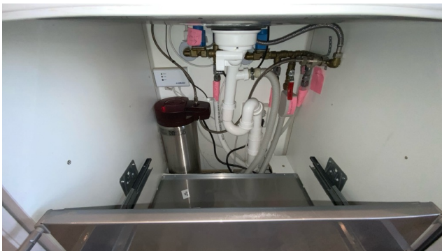
Endemuffer mangler, men det er waterguard med fuktfølger.
