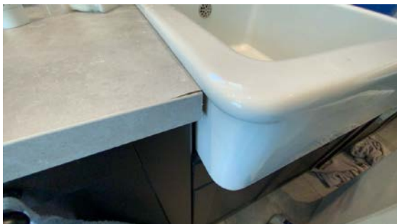
Mindre skade på benkeplate.
