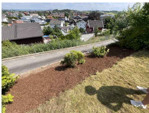
Manglende sikring av forstøtningsmur.
