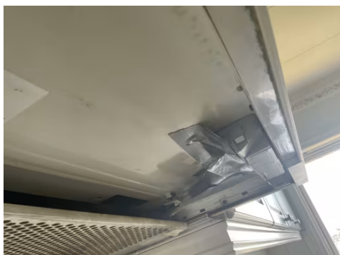
Avtrekk på ventilator fungerer, men den har blitt fikset på provisorisk med teip.
