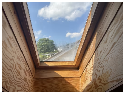
Tak vinduer er punkterte.
