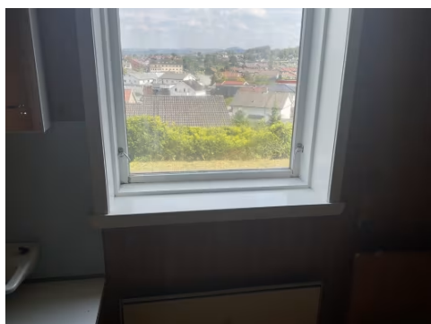
Tegn til kondensering i enkelte vinduer.
