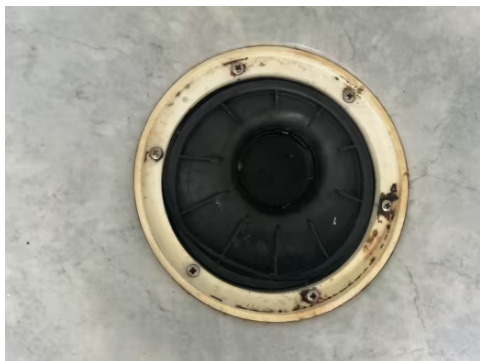
Sluk i dusjsone. Synlig klemring og belegg er tettesjikt.
