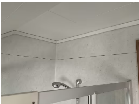
Det er gliper mellom belegg på vegg.
