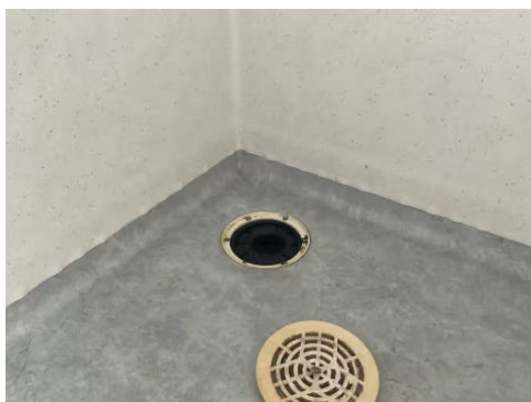
Belegg har begynt å slippe i overgang vegg/gulv.
