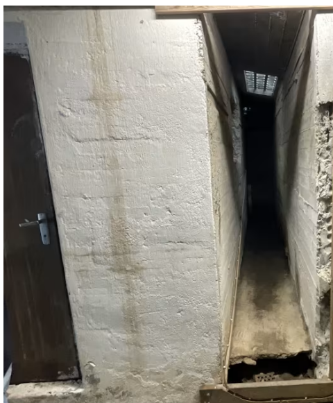
Ekstra grunnmur etablert under påbygging i 1985. Det er et hulrom der passasje starter. Ukjent om denne er godkjent den er ikke synlig på tegning.
