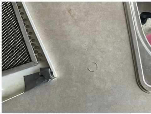
Skade i benkeplate.
