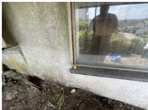
Råte i vindu i underetasje.
