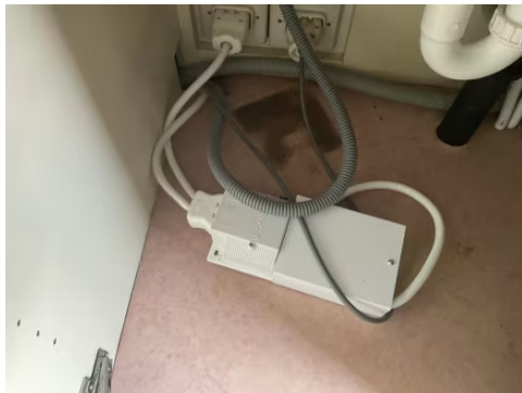
Svi merke i belegg i benkeskap under vask.
