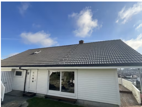
Manglende snøfangere på tak.
