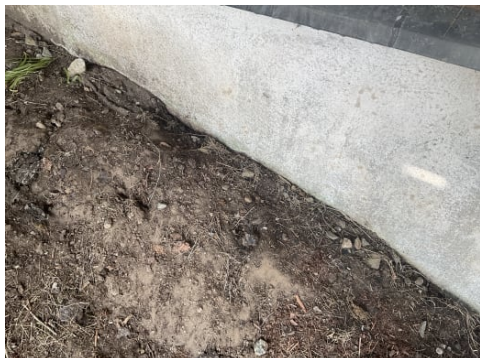
Ikke synlig grunnmursplast.
