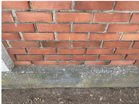
Sprekk i teglstein, samt det er manglende i pussing i fuger mellom teglstein.
