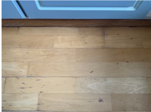
Gamle fukt merker på kjøkken gulv.
