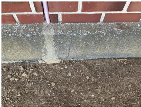
Sprekk i pusslag på grunnmur.
