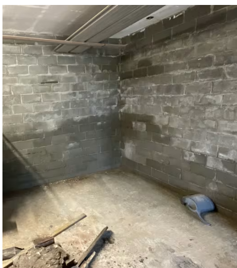
Fukt og saltutslag på mur i garasjerom.
