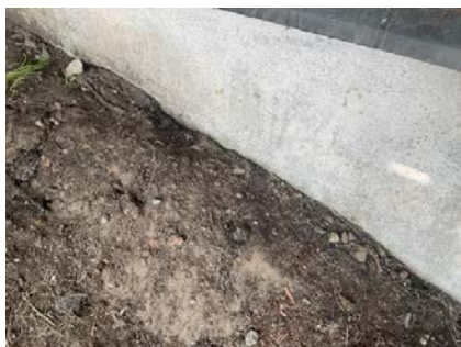
Ikke synlig grunnmursplast.
