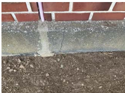
Sprekk i pusslag på grunnmur.
