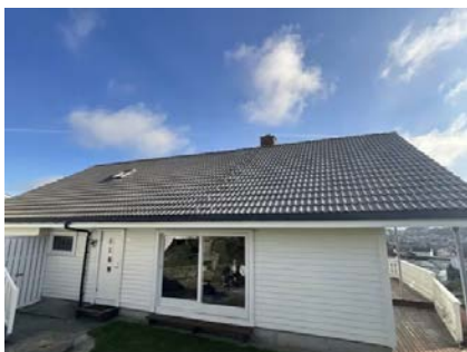
Manglende snøfangere på tak.
