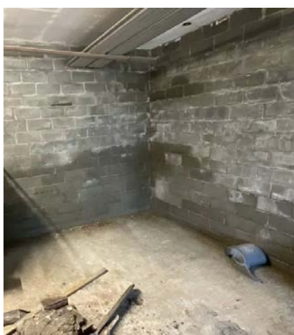
Fukt og saltutslag på mur i garasjerom.
