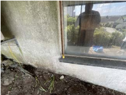
Råte i vindu i underetasje.
