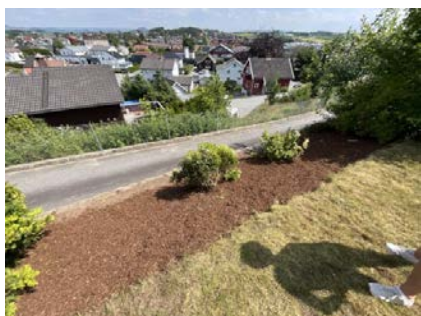
Manglende sikring av forstøtningsmur.
