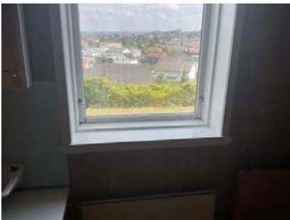
Tegn til kondensering i enkelte vinduer.
