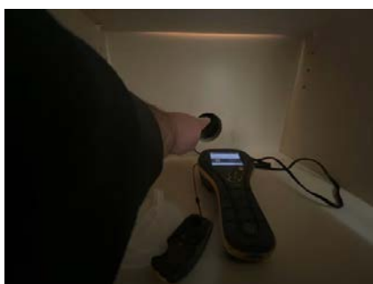
Hultaking utført fra tilstøtende rom. Bilde som vises på apparatet tilsier et målte verdier er under 7%. Det er registrert at det er brukt plastfolie i konstruksjonen mot våtrom.
