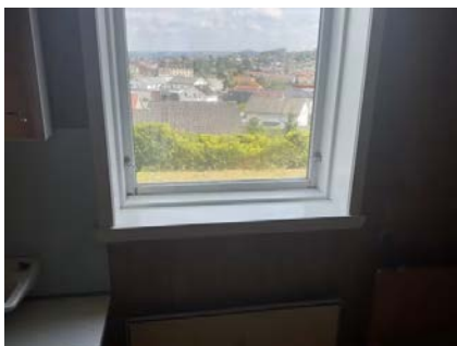
Tegn til kondensering i enkelte vinduer.
