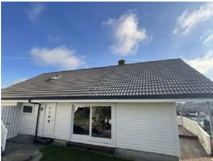
Manglende snøfangere på tak.
