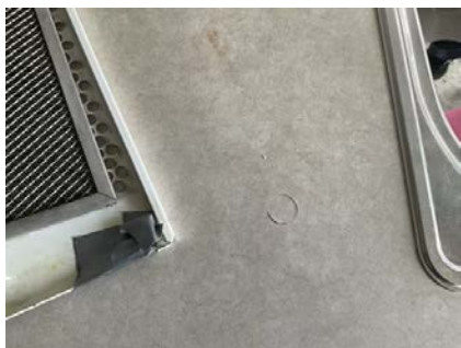
Skade i benkeplate.
