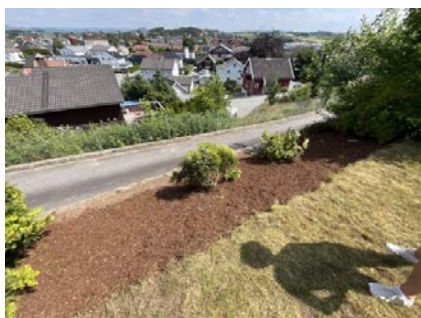
Manglende sikring av forstøtningsmur.
