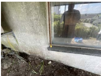
Råte i vindu i underetasje.
