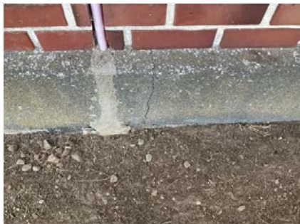
Sprekk i pusslag på grunnmur.
