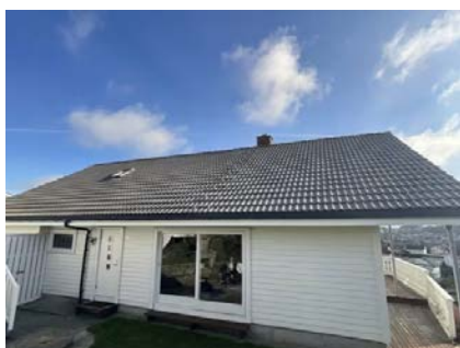
Manglende snøfangere på tak.
