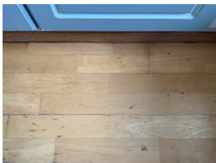
Gamle fukt merker på kjøkken gulv.
