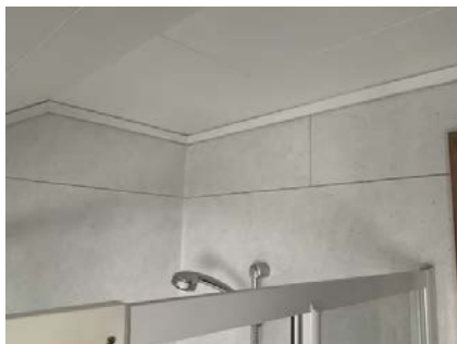
Det er gliper mellom belegg på vegg.
