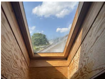
Tak vinduer er punkterte.
