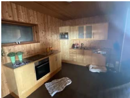
Innredning med glatte fronter og benkeplate i laminat. Det mangler avtrekk over stekesonen.
