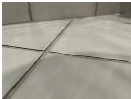
Noe slitte fuger i dusjsone. - Normalt med tanke på alder på overflater.
