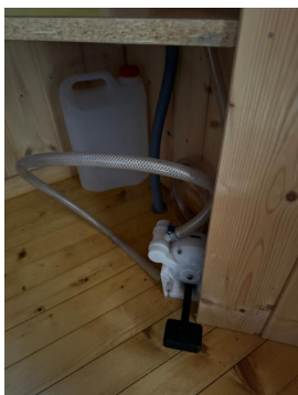
Fotpumpe under vask på toalettrom
