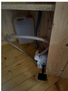
Fotpumpe under vask på toalettrom
