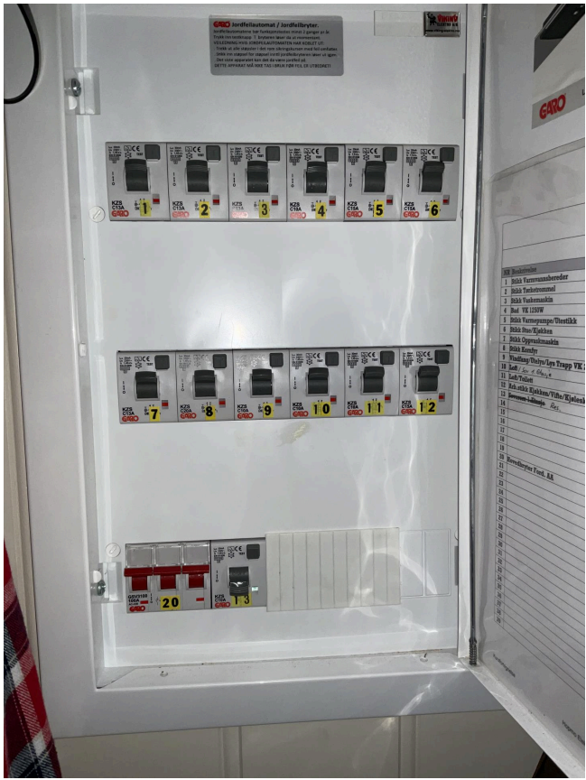
Sikringskapp i bolig med automatsikringer
