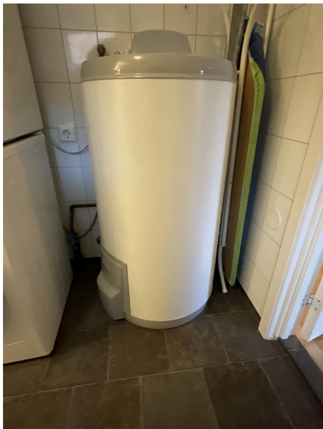
Bilde av v.v.bereder og stoppekran mellom v.v.bereder og vaskemaskin
