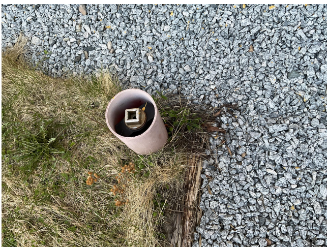
Utvendig stoppekran ved bolig
