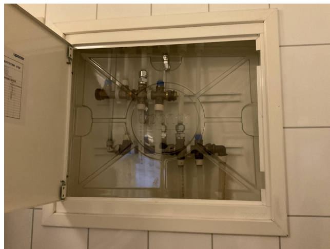
Fordelerskap vann rør i rør på bad
