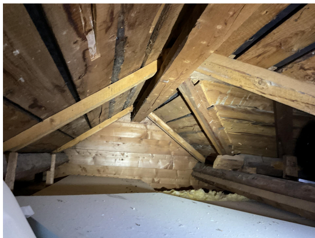
Kaldloft hovedbygg. Lav høyde, eldre taktro og begrenset kontrollerbarhet på eldre kaldloft
