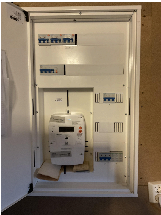
Elskap i garasjen med hovedsikringer og måler
