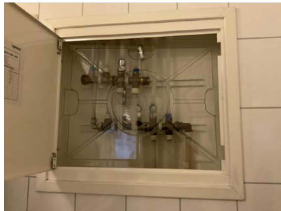
Fordelerskap vann rør i rør på bad
