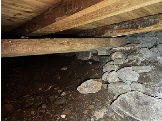
Det finnes trebjelkelag som ikke har understøttelse i krypkjeller
