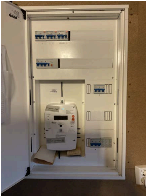
Elskap i garasjen med hovedsikringer og måler
