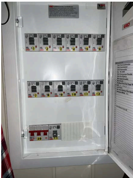
Sikringsskap i bolig med automatsikringer
