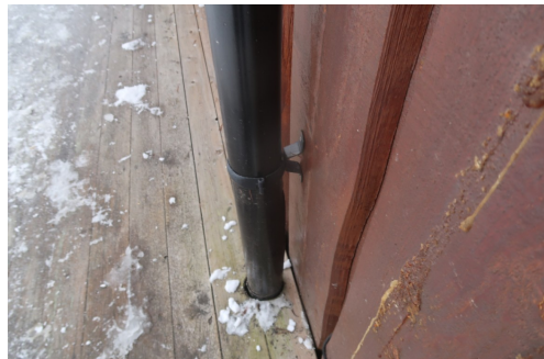
Frostsprengt nedløpsrør mot sørvest
