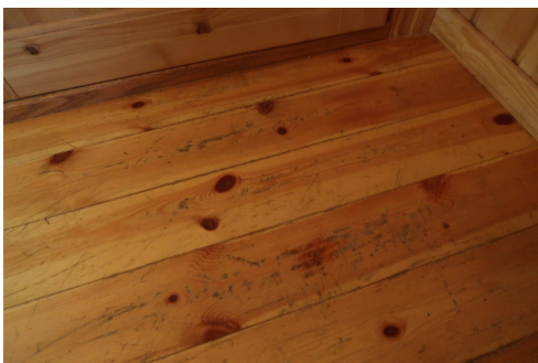
Bilde viser eksempel på slitasje på gulvoverflate
