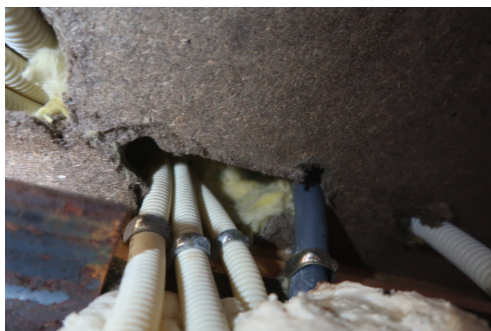
Bilde viser utettheter ved gjennomføringer i plater
