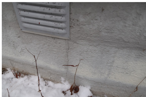
Riss i grunnmur mot nord
