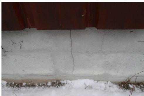
Sprekk i grunnmur mot nord
