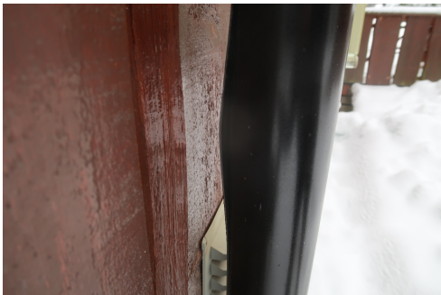
Frostsprengt nedløpsrør mot nordvest
