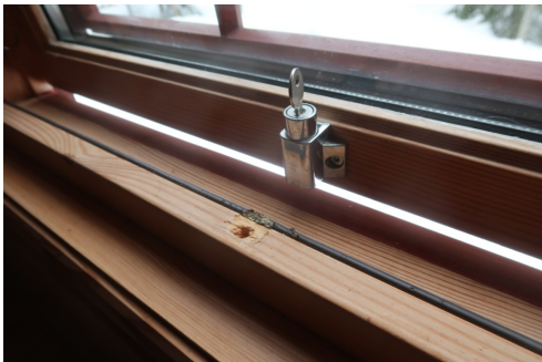
Lokal skade i vinduskarm på soverom mot nordøst.
