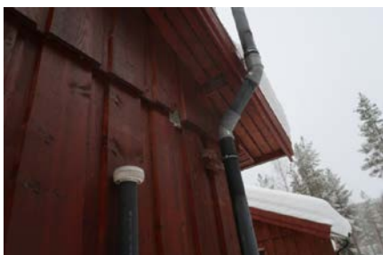
Hull etter tidligere gjennomføring av lufting fra forbrenningstoalett
