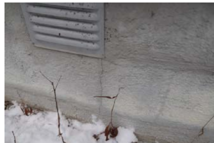
Riss i grunnmur mot nord
