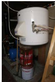
Bilde viser plassering og understøttelse av varmtvannsbereder
