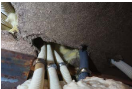
Bilde viser utettheter ved gjennomføringer i plater
