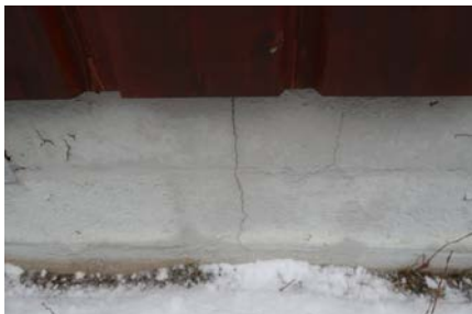
Sprekk i grunnmur mot nord
