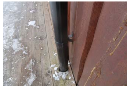
Frostsprengt nedløpsrør mot sørvest
