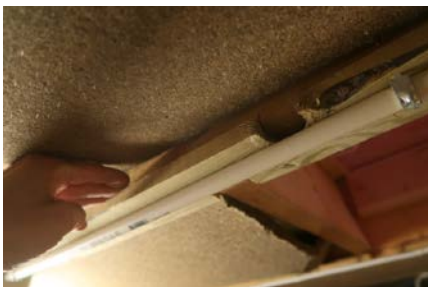
Bilde viser løse plater under entré og bad
