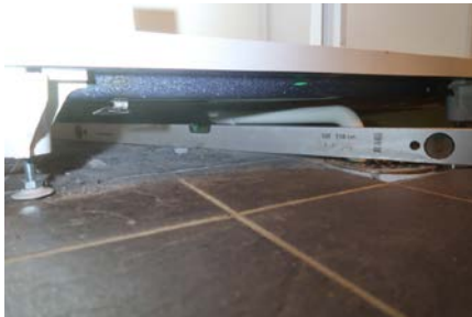
Bilde viser kontroll av fall mot sluk under dusjkabinett. Gulvet er tilnærmet flatt
