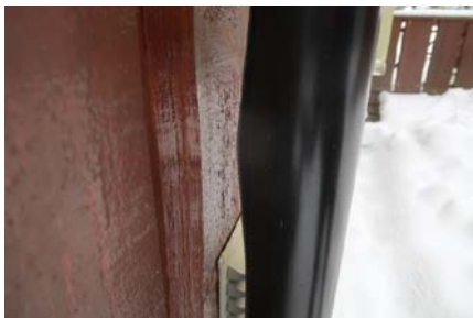
Frostsprengt nedløpsrør mot nordvest
