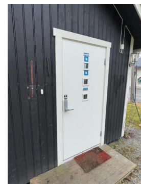
Manglende vannbrett over dør
