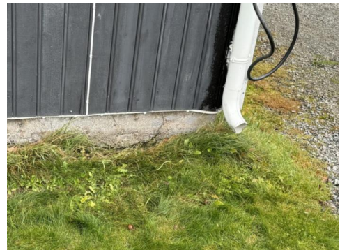
Sprekk i gammel grunnmur
