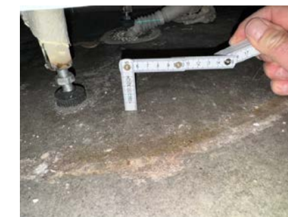
Målt høyde 19mm v/sokkel til dusjkabinett (høyeste punkt)
