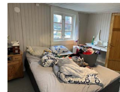
Det er målt 55mm høydeforskjell over hele rommet på hovedsoverom.
