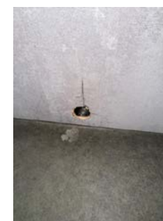
Drensrør fra vannfordelingskap stopper midt i våtromsplate.
