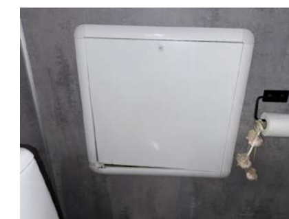
Skadet front på fordelerskap
