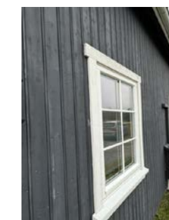
Vinduer med kun vannbrett under
