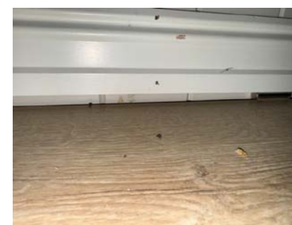
Større glipper mellom gulv og gulvlist i spisestue og stue.
