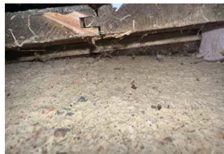
Liten/ingen luftning bak kledning
