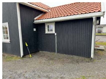
Tilbygg fra 2019 og resterende del av takflater mangler snøfangere.
