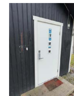
Manglende vannbrett over dør
