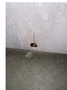
Drensrør fra vannfordelingskap stopper midt i våtromsplate.
