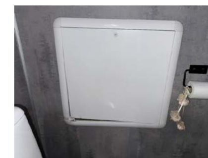
Skadet front på fordelerskap
