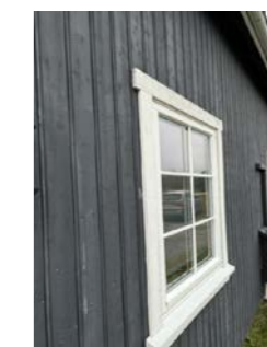
Vinduer med kun vannbrett under
