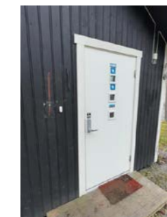
Manglende vannbrett over dør
