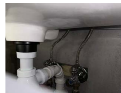
Hull i våtromsplate under servan (utett våtsone)
