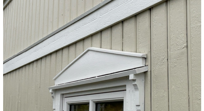
Det er ikke synlig beslag på vannbrett over vinduene.
