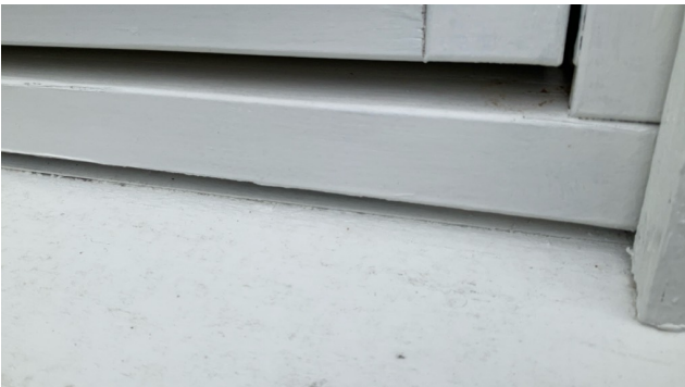
Synlig beslag under vinduene.
