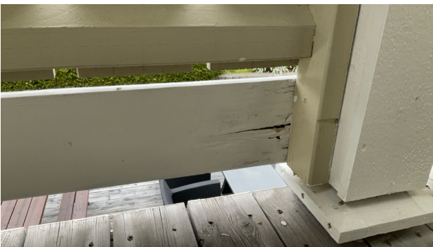
Råteskade i rekkverksbord.
