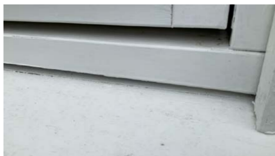
Synlig beslag under vinduene.
