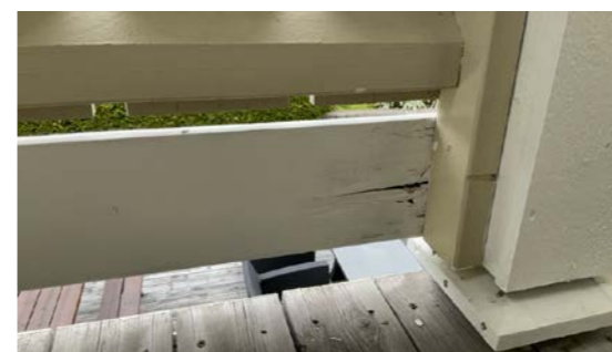
Råteskade i rekkverksbord.
