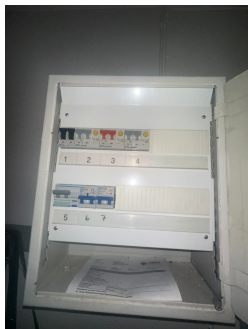
Sikringskap med automatsikringer.
