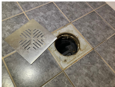
Sluk i dusjsone.
