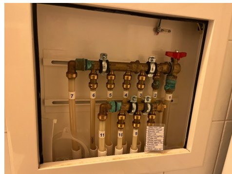
Fordelerskap med stoppekran.
