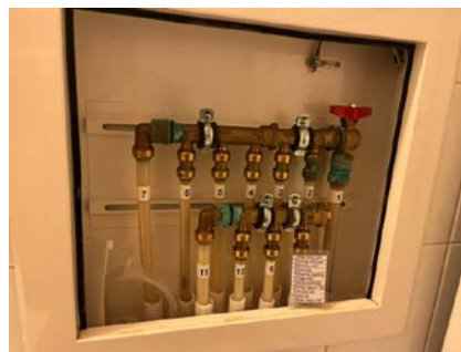
Fordelerskap med stoppekran.
