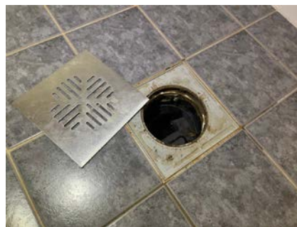
Sluk i dusjsone.
