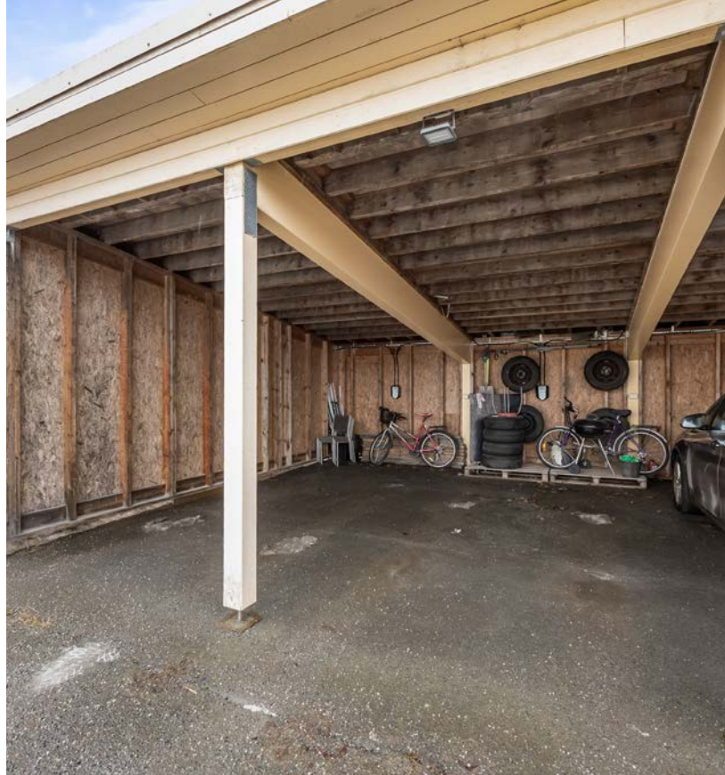
Til leiligheten medfølger det parkeringsplass i felles carportanlegg.
