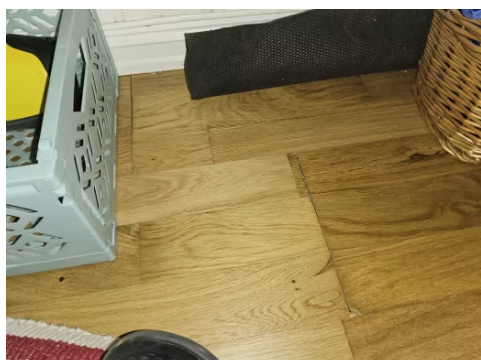
Det registreres enkelte gliper i parkettskjøter.
