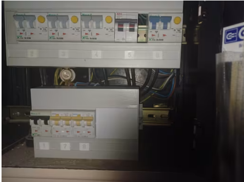
Sikringsskap er plassert på kjøkken.
