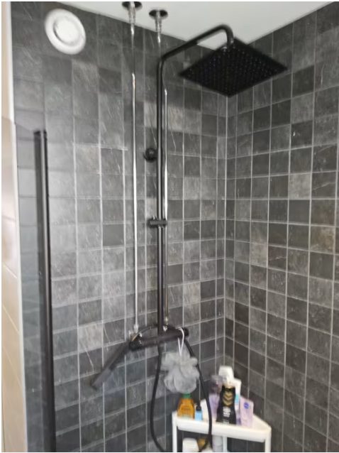
Dusjhjørne med vegghengt dusjarmatur (hånddusj og regndusj).
