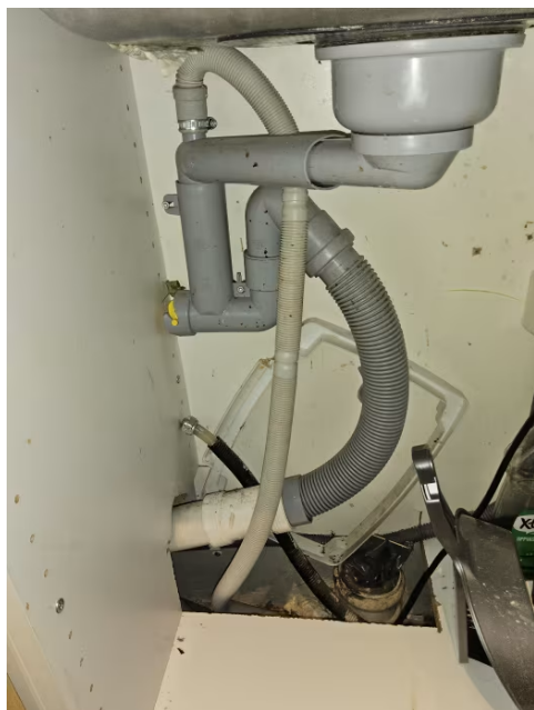
Leiligheten har synlige avløpsrør av plast.
