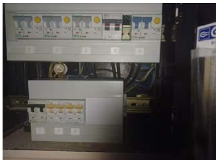
Sikringsskap er plassert på kjøkken.
