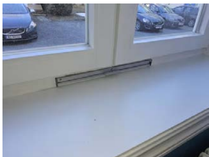
Naturlig tilluft fra spalteventiler i vinduer.
