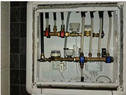
Fordelerskap med stoppekraner og automatiske vannstoppeventiler er plassert på vegg i toalettrom.
