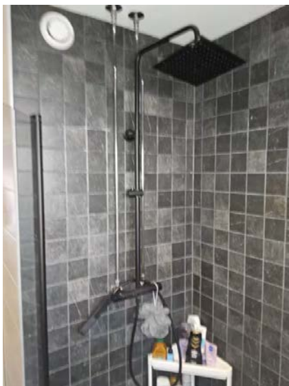
Dusjhjørne med vegghengt dusjarmatur (hånddusj og regndusj).
