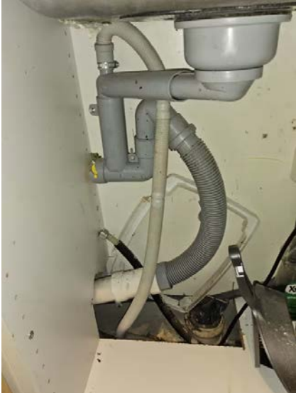
Leiligheten har synlige avløpsrør av plast.
