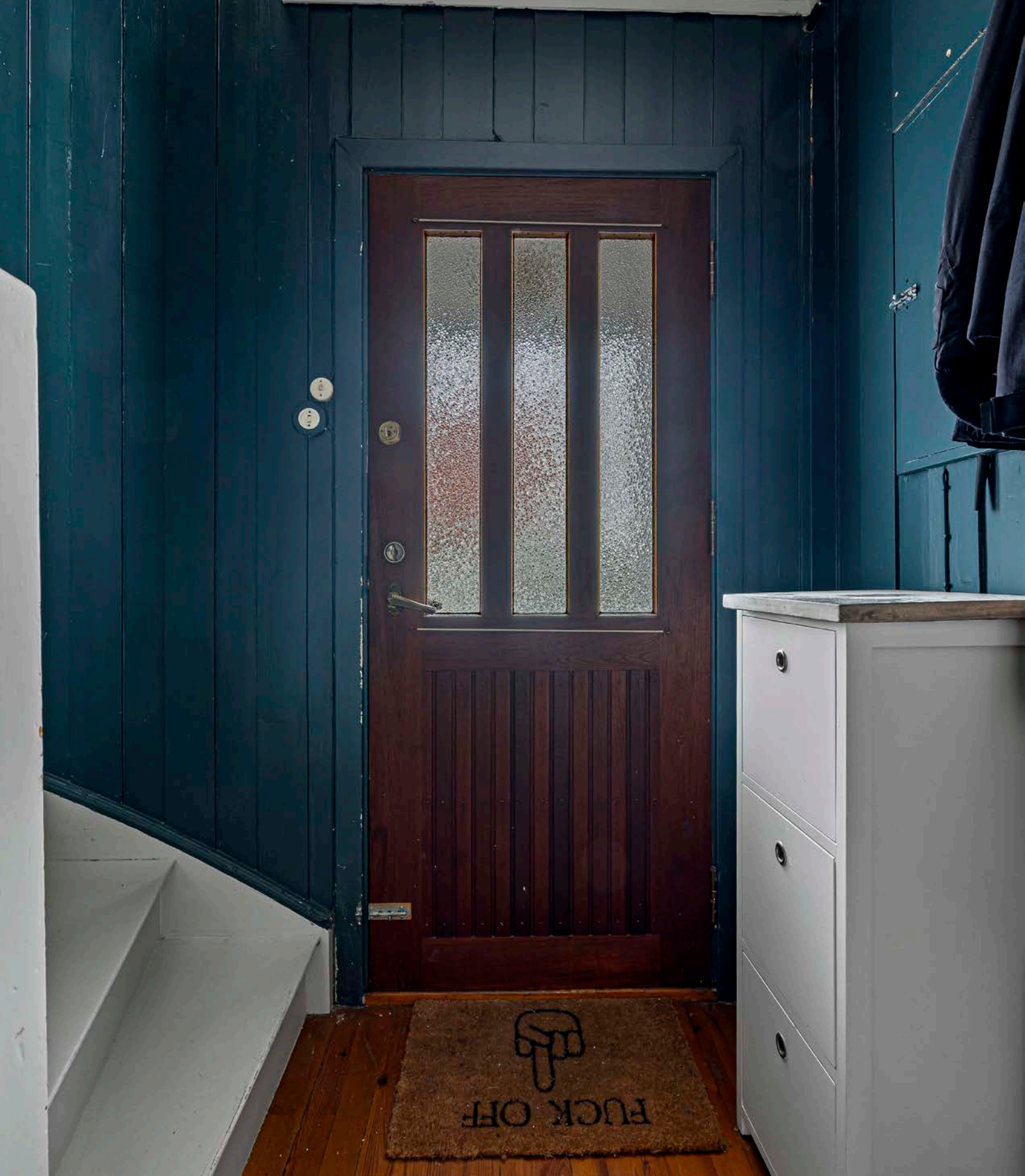
Separat entré til leilighet i 2.etasje. Her er det VV-bereder og opplegg for vaskemaskin under trapp
