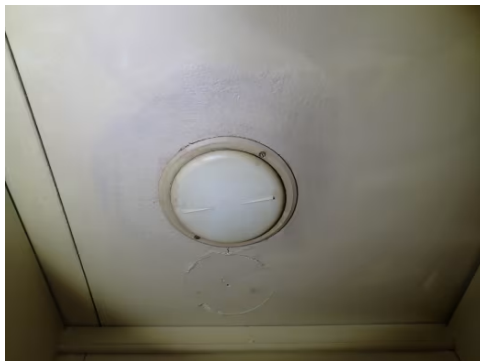
Svelling rundt avtrekksventil
