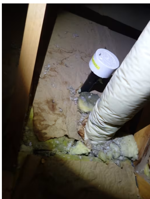
Under gjennomføring av kanaler over tak. Museaktivitet og fuktmerker
