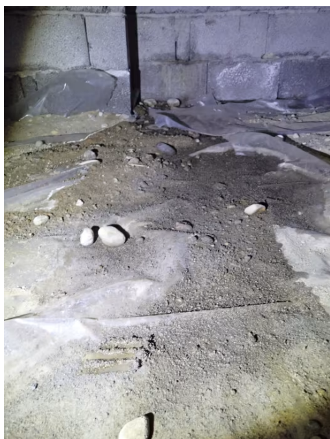
Inne i krypkjeller, ved vindfang. Synlig vann/fukt oppå plasten
