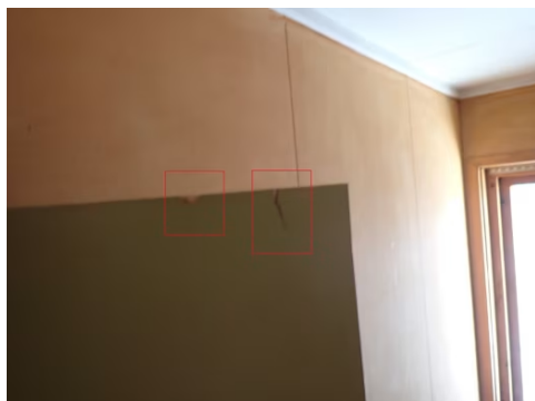
Slitasje/sprekk i boddør
