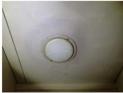
Svelling rundt avtrekksventil
