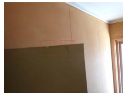
Slitasje/sprekk i boddør
