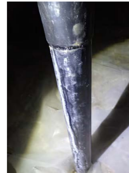
Rør i krypkjeller
