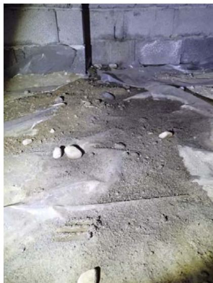
Inne i krypkjeller, ved vindfang. Synlig vann/fukt oppå platen
