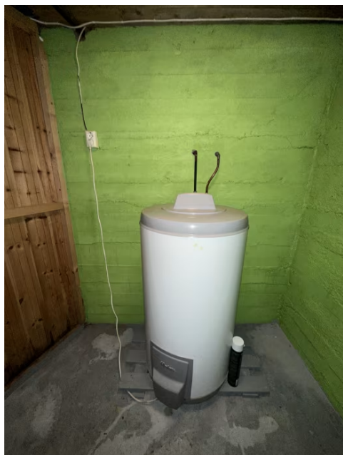
Bereider plassert i kjellerrom.
