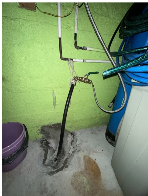
Hovedinntak/rør er ikke tilfredstillende festet.
