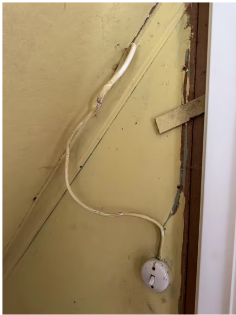
Kabel og bryter er ikke betryggende festet.
