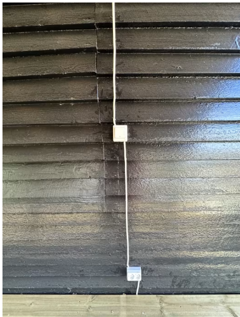
Viser bryter og stikkontakt for bruk innendørs montert ute.
