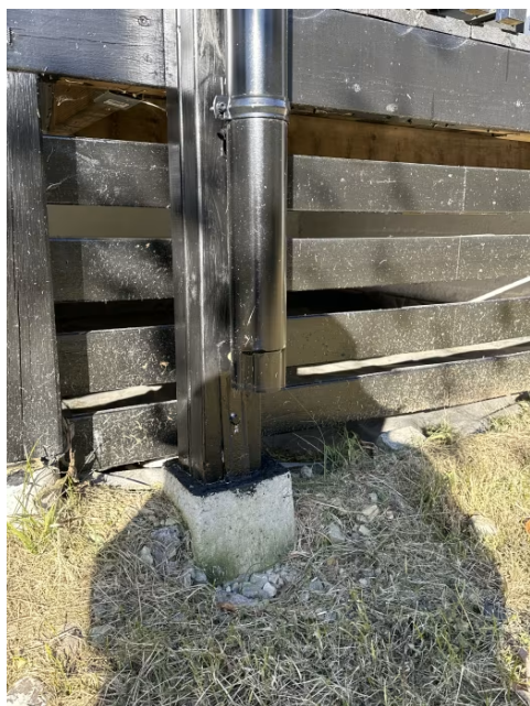
Nedløpsrør mangler utkast/drensrør.
