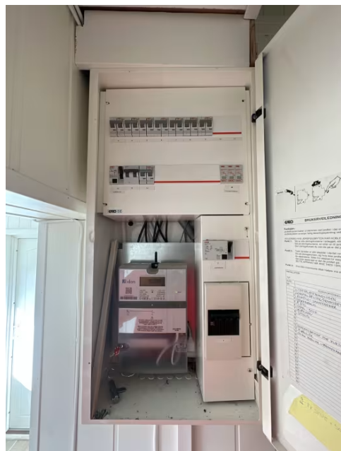
Viser sikringsskap plassert i gang.
