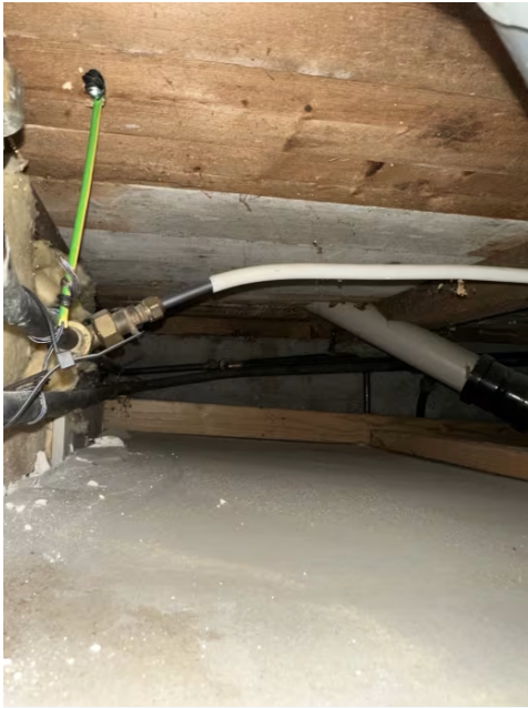
Rør fremstår ikke som tilstrekkelig festet.
