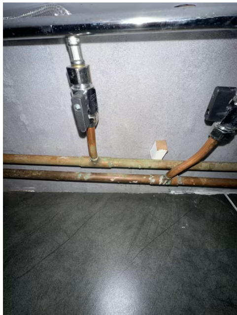
Åpne glipper mellom gulvfliser og vegg. Fremstår som utett.
