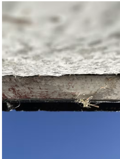
Viser manglende lufting av kledningen.
