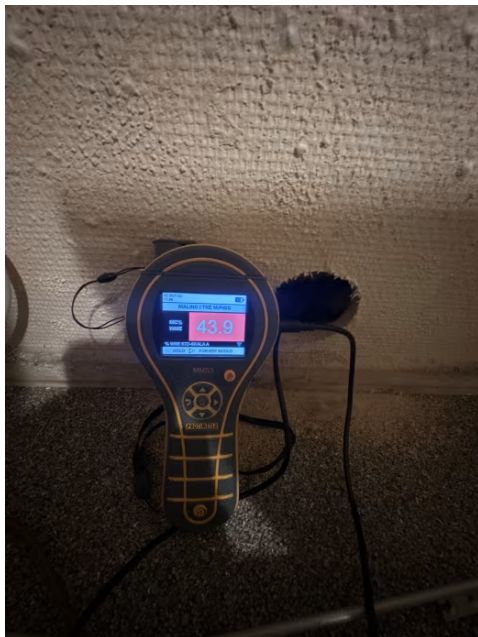
Ved hulltaking registreres høye verdier.
