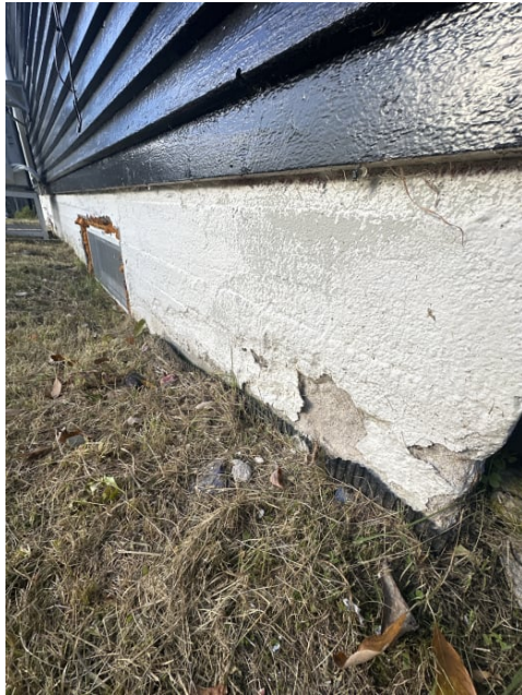
Viser løsnet murpuss på grunnmur.
