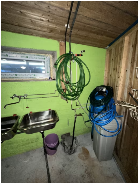
Viser vanninntak og renseanlegg i kjeller.
