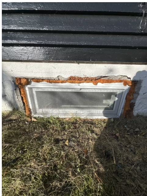
Flere vinduer med terrengkontakt.
