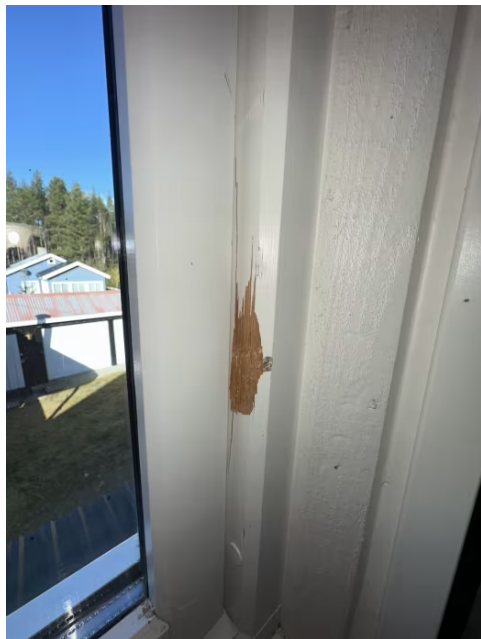
Viser skade i karm på soverom.
