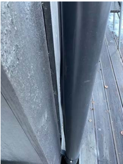
Frostspreg i nedløp.
