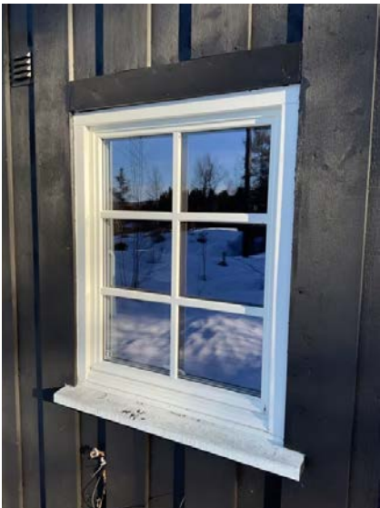
Manglende vannbrett over vindu
