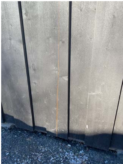
Sprekker i kledning.
