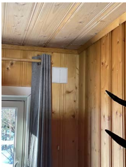
Klaffventil i yttervegg.
