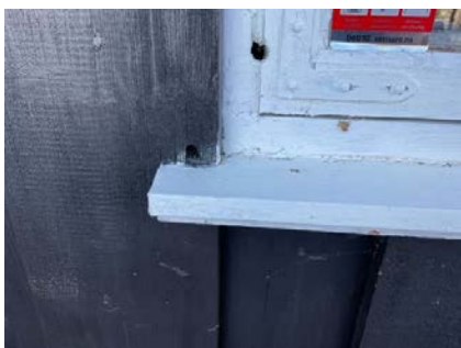
Panel ned til vannbrett
