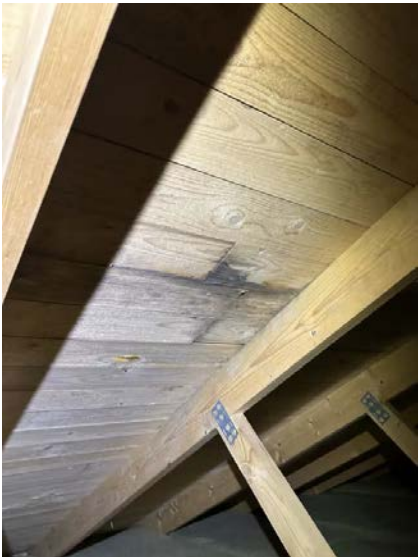
Svertesopp i undertak.
