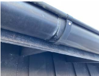
Utett skjøt i takrenne.
