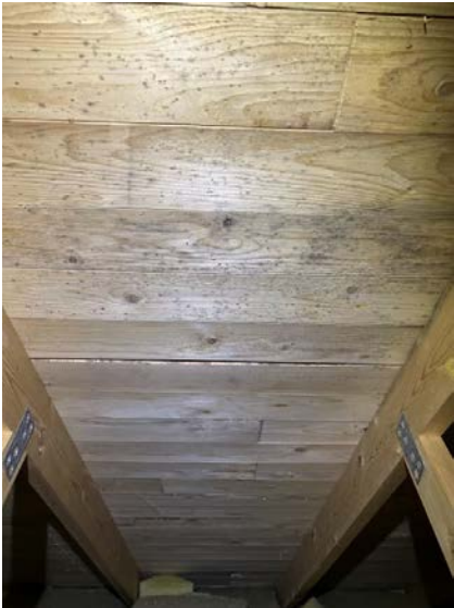
Svertesopp i undertak.
