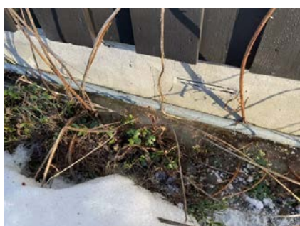
Fall på terreng inn mot grunnmur.
