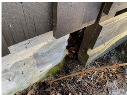
Taknedløp rett til terreng under terrassen.
