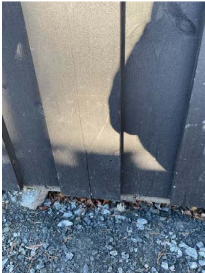
Sprekker i kledning.
