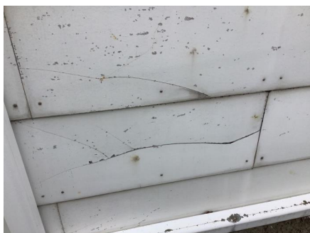
Eksempel på eternittplater med skader.
