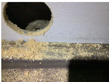
Hulltaking, og det er ikke svill å måle fuktinnholdet i.
