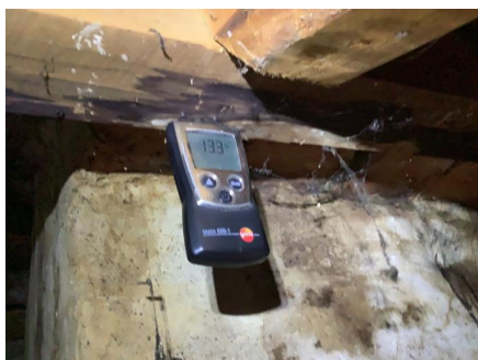
Fuktskjolder rundt pipe, og det måles tørt.
