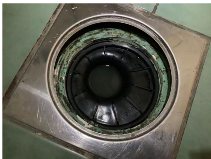
Plastsluk, og synlig smøremembran rundt sluk.
