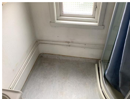
Rommet er umoderne med slitasje.
