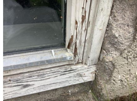
Eksempel på værslitt vindu.
