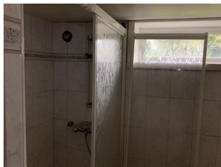
Vindu er plassert i den definerte våtsonen ved dusj.
