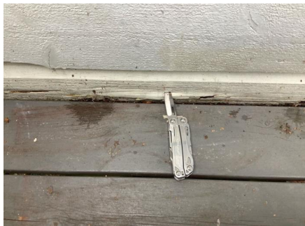
Eksempel på råteskadet bordkledning.
