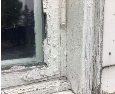
Eksempel på værslitt vindu.
