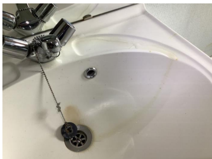
Lekkasje fra servantbatteri.
