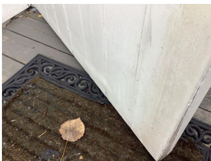
Svellskadet dørblad på hovedytterdør.
