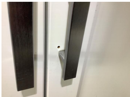
Synlig, boret hull i skapdør.
