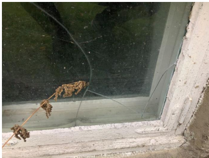
Sprukket glass i kjellervindu.
