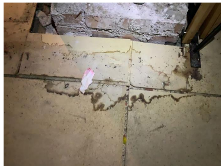
Fuktskjolder på gulv nedenfor pipe.
