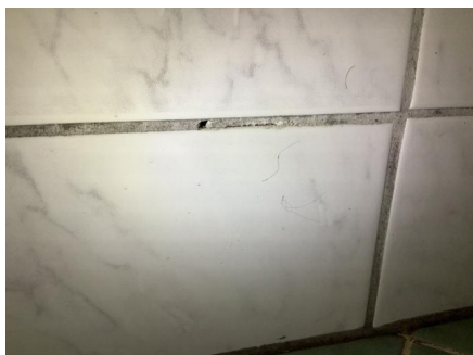
Riss i flisfuge på grunnmur.
