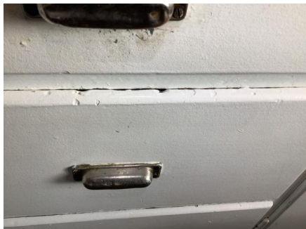
Slitasje på innredning.
