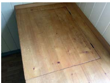
Tidligere hull er enkelt tettet.
