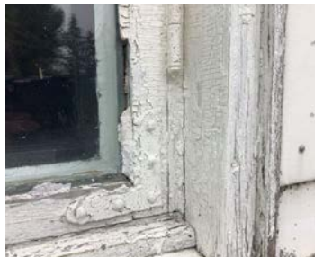
Eksempel på værslitt vindu.
