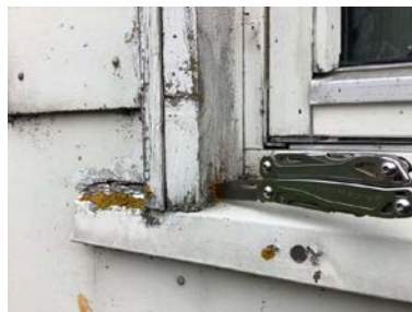
Omramming er ført helt ned til vannbrett, og dette har stedvis ført til råteskader.
