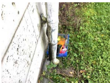
Frostsprengt nedløpsrør og mangelfull bortledning av takvann.
