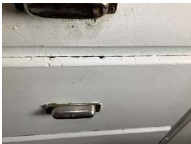
Slitasje på innredning.
