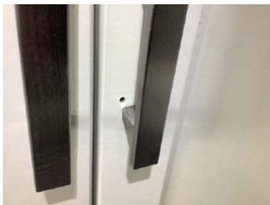
Synlig, boret hull i skapdør.
