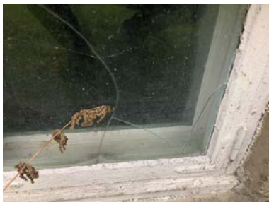
Sprukket glass i kjellervindu.
