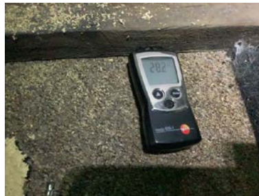
Fuktmåling i plank utenpå sponplate, og det er vått.
