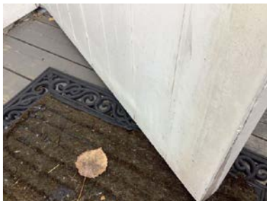
Svellskadet dørblad på hovedytterdør.
