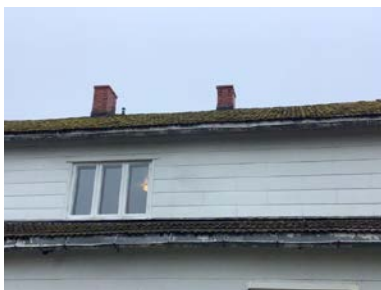
Mosedannelse på taktekking.
