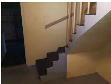
Rekkverk er ikke montert i bunnen av kjellertrapp.
