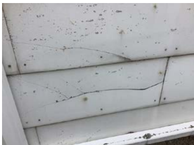
Eksempel på eternittplater med skader.
