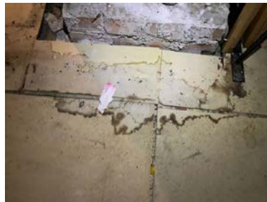
Fuktskjolder på gulv nedenfor pipe.
