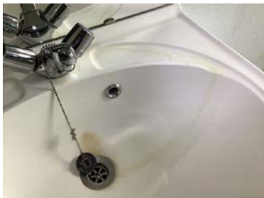
Lekkasje fra servantbatteri.
