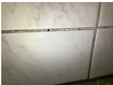
Riss i flisfuge på grunnmur.
