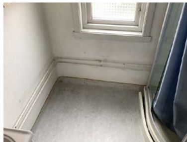
Rommet er umoderne med slitasje.
