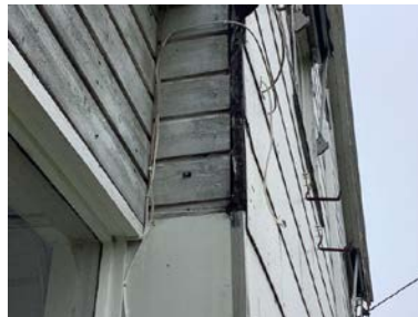
Eksempel på utette overganger i fasade.
