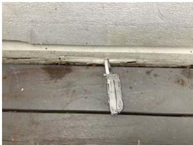
Eksempel på råteskadet bordkledning.
