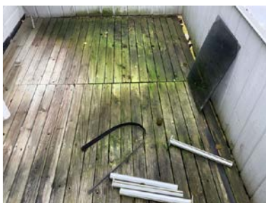
Værslitt tremmegulv på luftebalkong.
