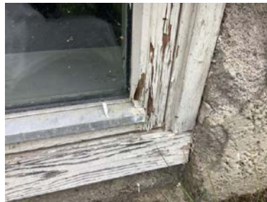
Eksempel på værslitt vindu.
