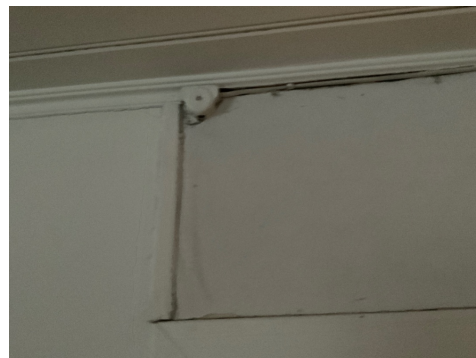
Eldre ledninger og koblingsboks
