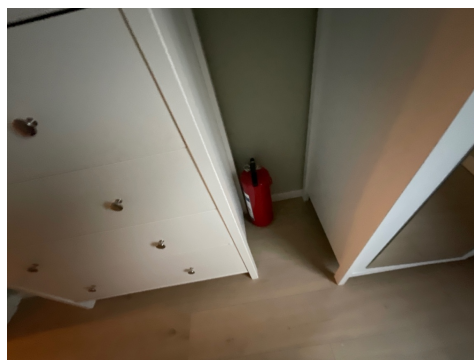
Røykvarsler i entreen, på soverommet og brannslukningsapparat på soverommet
