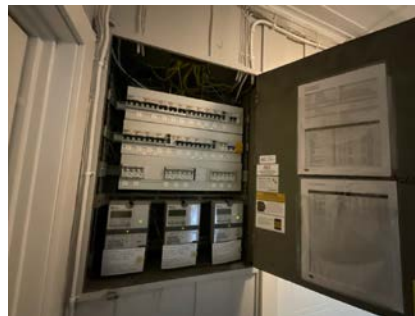
Sikringsskap i felles trappegang
