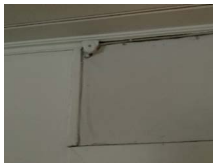
Eldre ledninger og koblingsboks
