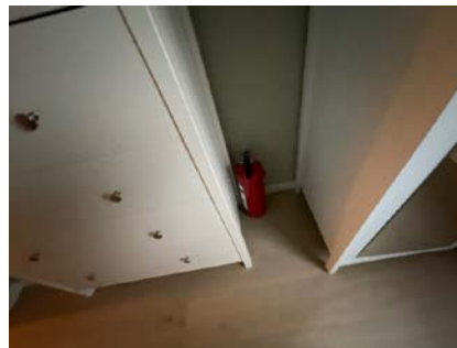
Røykvarslar i entreen, på soverommet og brannslukningsapparat på soverommet
