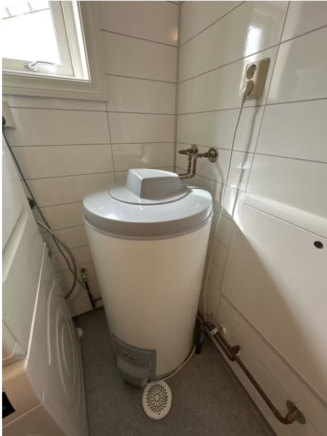
Viser bereder plassert på toalettrom/vaskerom.
