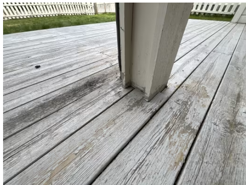
Terrassebord og tresøyle med noe slitasje og påvirket av lekkasje fra takrenne.
