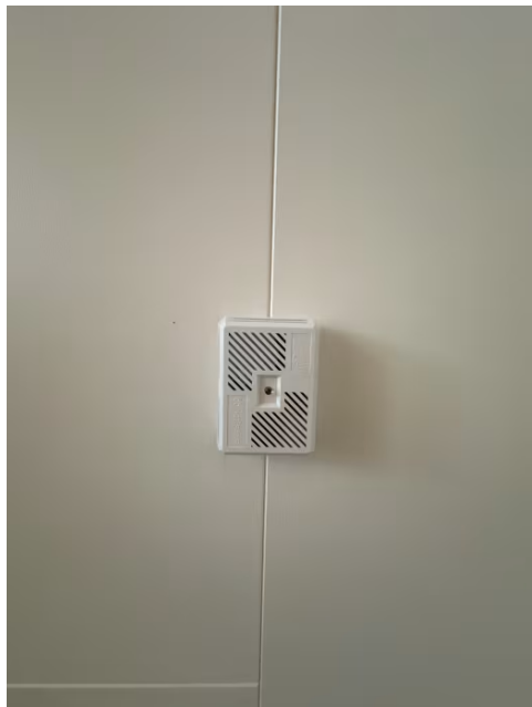
Viser brannvarsling i himling.
