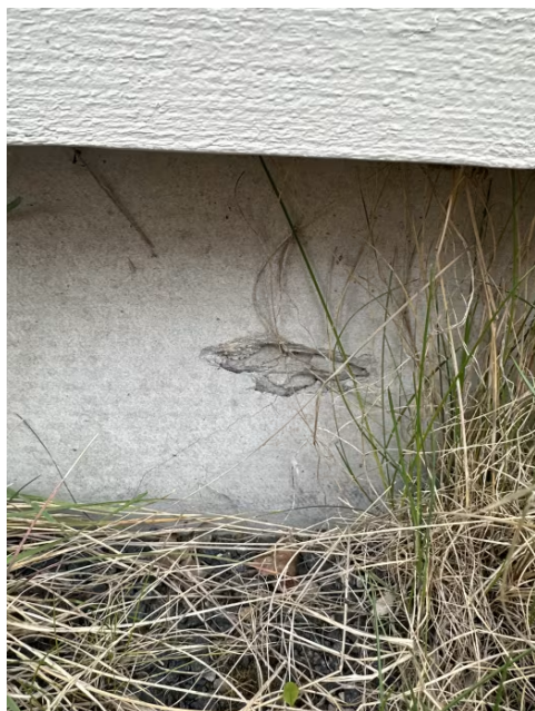
Viser riss i grunnmursplate.
