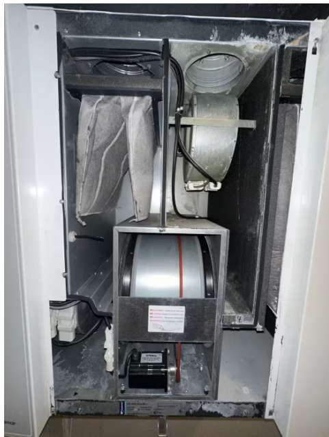
Viser ventilasjonsaggregat innvendig.
