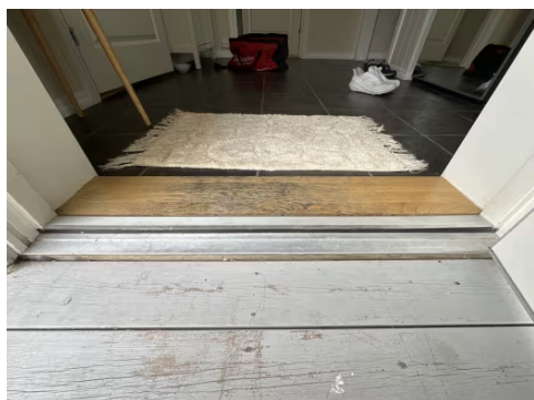
Det er ufullstendig beslag under inngangsdør.
