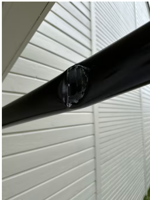
Bulk på nedløpsrør ved inngangsparti..
