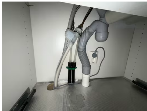
Viser vann og avløpsinnstallasjoner under kum.
