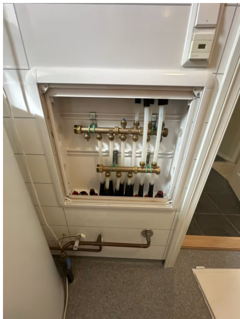
Viser vanninntak, hovedstoppekran og fordelerskap.
