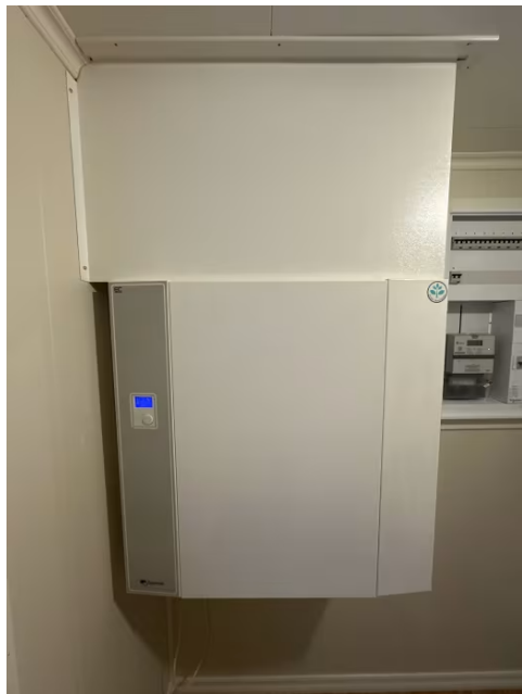
Ventilasjonsaggregat plassert på bod i 2.etasje.
