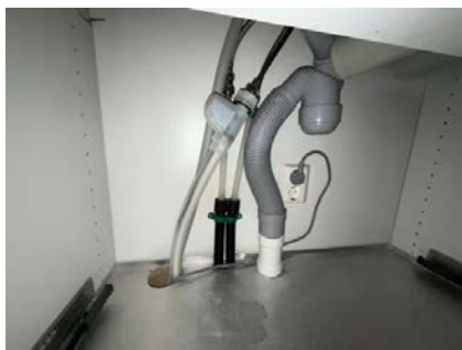
Viser vann og avløpsinnstallasjoner under kum.
