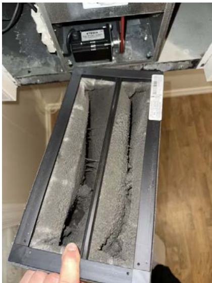
Filter må byttes.
