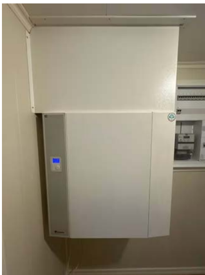
Ventilasjonsaggregat plassert på bod i 2.etasje.
