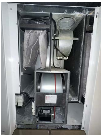
Viser ventilasjonsaggregat innvendig.
