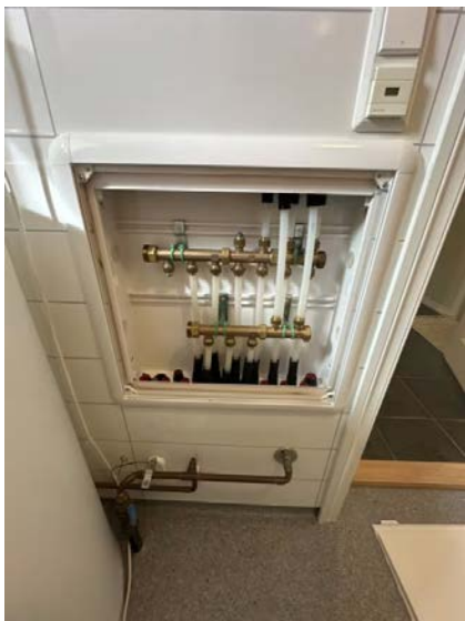
Viser vanninntak, hovedstoppekran og fordelerskap.
