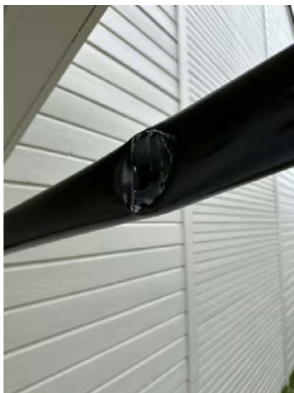
Bulk på nedløpsrør ved inngangsparti..
