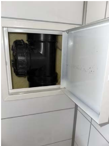
Det er etablert en stakeluke på kloakkstammen plassert i luke på vaskerom
