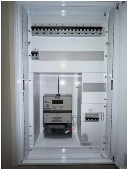
Viser sikringsskap plassert på bod i 2.etasje
