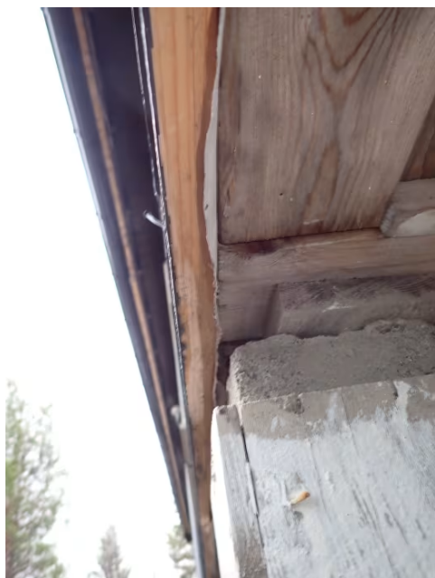
Begrenset/manglende lufting mellom kledning og konstruksjon
