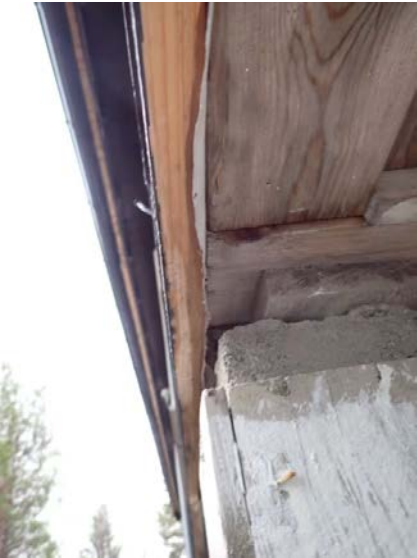
Begrenset/manglende lufting mellom kledning og konstruksjon
