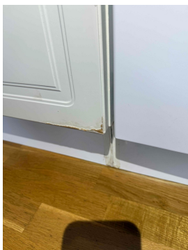
Bildet viser kjøkkenskap med fukt/svelleskader.
