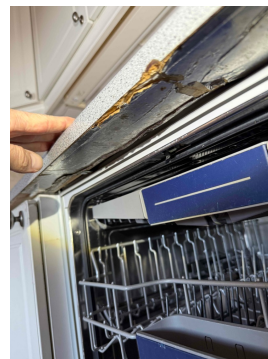
Bilde viser benkeplate med noe fukt/svelleskader.
