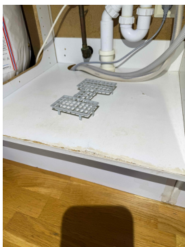
Bildet viser kjøkkenskap med fukt/svelleskader.
