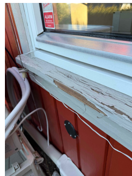
Bidet viser vannbrett under vinduet.
