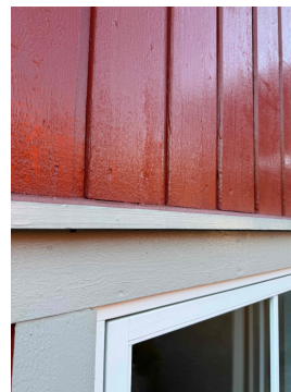
Bildet viser kledning med liten/ingen klaring til vannbrett.
