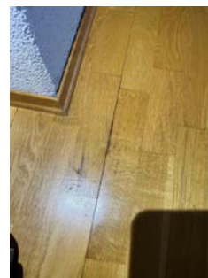
Bildet viser fuktmerker på parkett ved plass til kjøleskapet.
