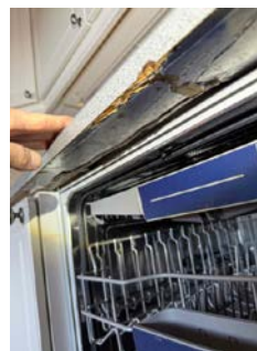
Bilde viser benkeplate med noe fukt/svelleskader.
