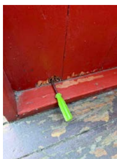
Bildet viser råteskade i rekkverksbod.
