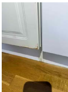
Bildet viser kjøkkenskap med fukt/svelleskader.
