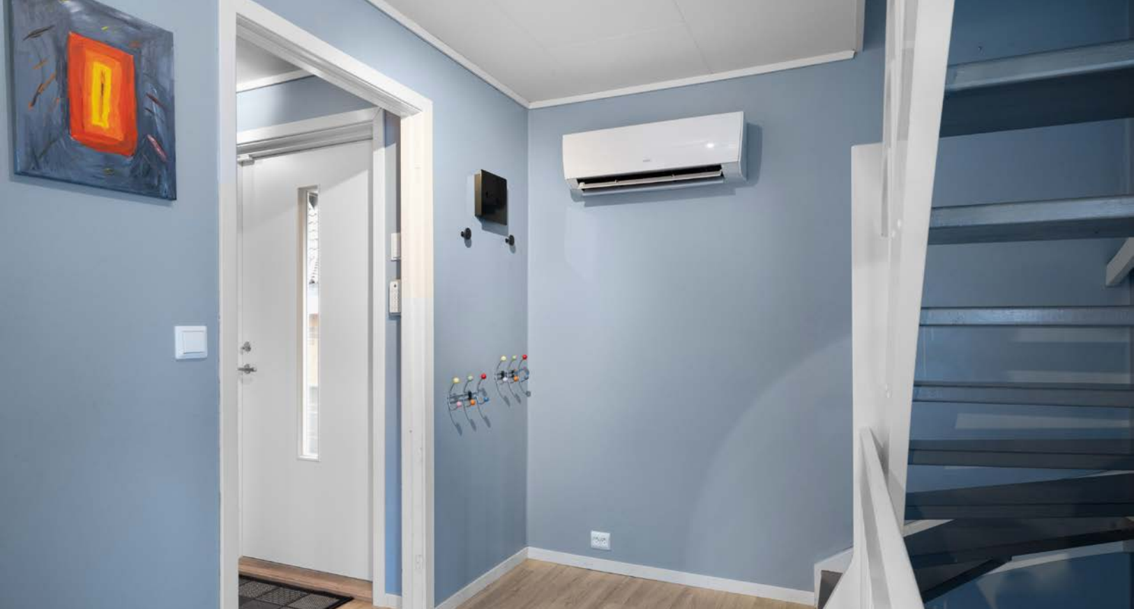
Varmepumpe i gang er hovedkilden til oppvarming i boligen.
