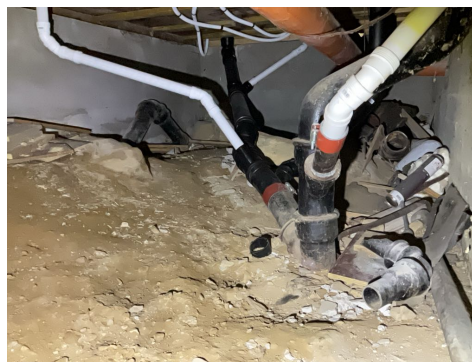
Gammelt avløp i grunnen i støpejern.
