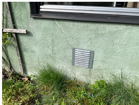
Noe setningsprekker i grunnmur.
