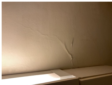
Løs maling på yttervegg.
