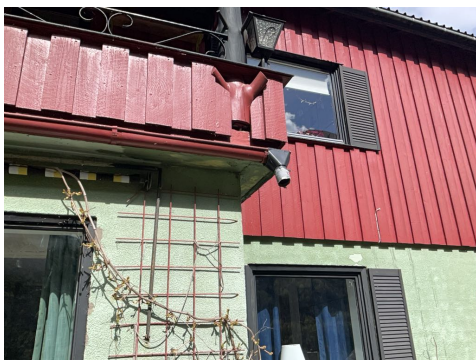
Manglende nedløpsrør på veranda mot sør.
