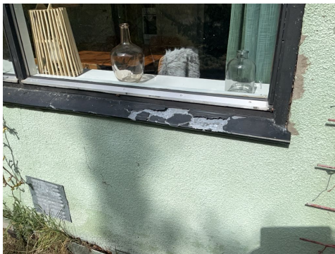
Vindusbeslag flasser i overflatebehandlingen
