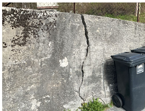
Sprekk i støttemur mot vei..
