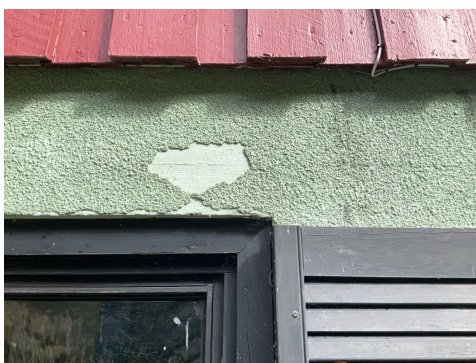
Løs puss på grunnmur.
