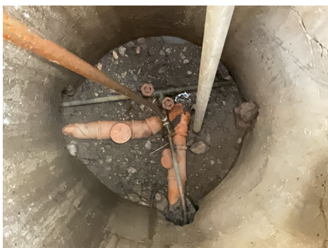
Plast på avløpsrør og vannrør i metall.
