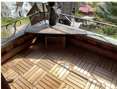
Lavt rekkverk på lufteveranda utenfor stuen.
