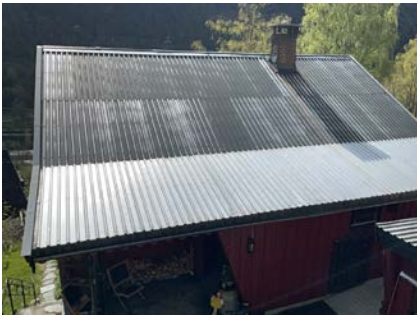
Tidsmessig slitasje på takplater.
