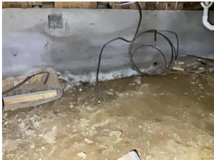
Fuktopptrekk i ringmur i krypkjeller.
