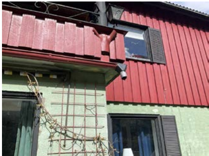
Manglende nedløpsrør på veranda mot sør.
