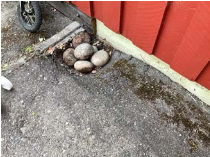
Lokalt fall på terreng mot grunnmur.
