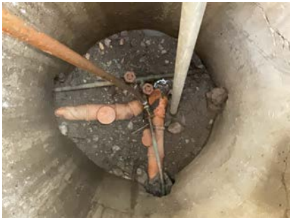
Plast på avløpsrør og vannrør i metall.
