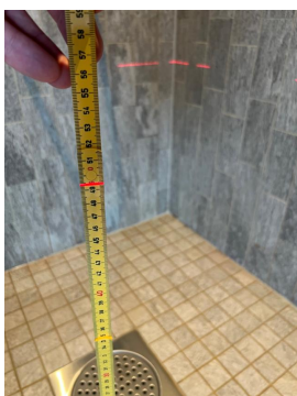
Høyde ved sluk er 49,5 cm ved sluk, fall er under krav på gulv og i dusj
