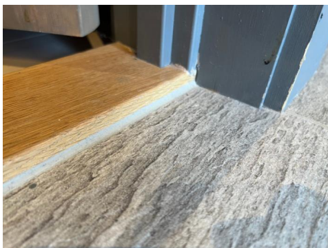
Ingen synlig oppbrett ved terskel
