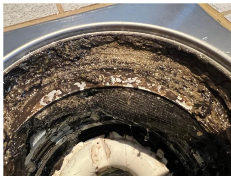
Synlig slukmansjett korrekt under klemring i sluk
