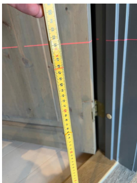
Fall er målt med laser, høyde 47,5 cm ved dørterskel
