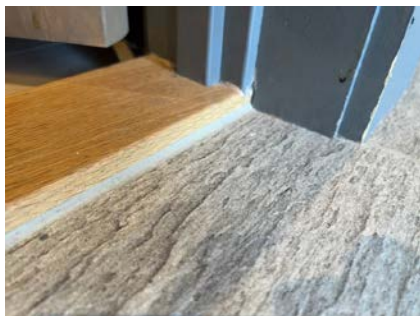
Ingen synlig oppbrett ved terskel
