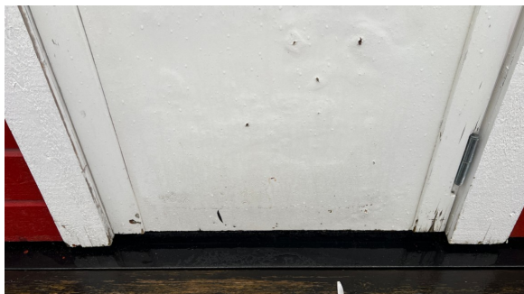
Fuktskader på balkongdør mot vest
