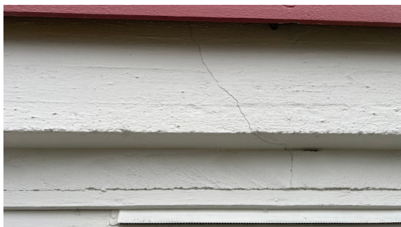
Sprekk i murover vindu
