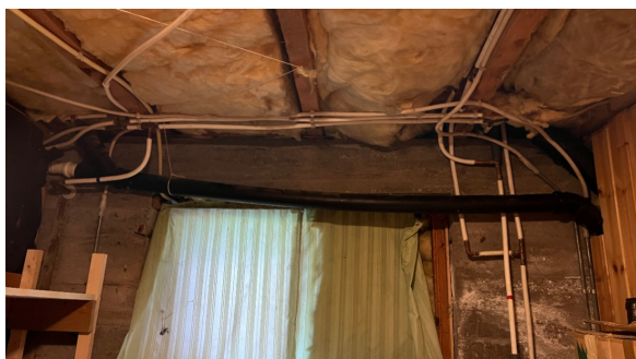
Synlige vannrør og avløpsrør i underetasjen
