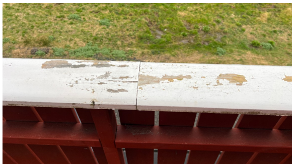
Værslitt topprekke på rekkverk mot vest
