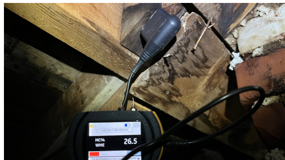
Fukt i treverk rundt pipen
