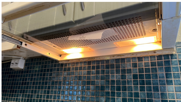
Kjøkkenventilator er funksjonstestet
