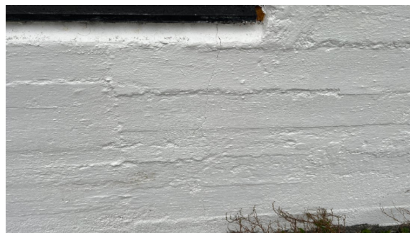
Sprekk i mur under vindu
