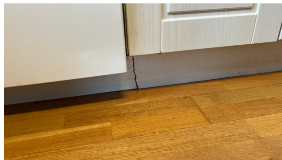
Skade på sokkellist
