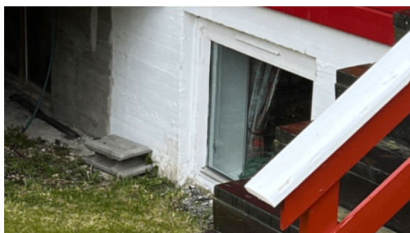
Vindu ligger for nært terrenget
