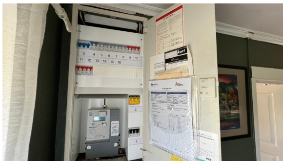
Sikringsskapet er plassert i 2. etasje
