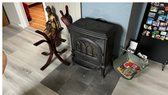
Vedovn i underetasjen
