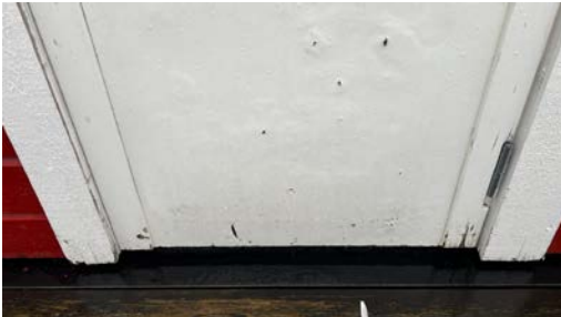
Fuktskader på balkongdør mot vest
