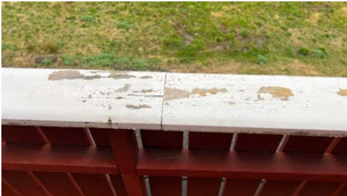
Værslitt topprekke på rekkverk mot vest
