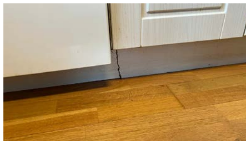
Skade på sokkellist
