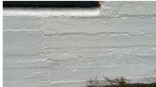
Sprekk i mur under vindu
