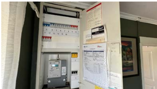
Sikringsskapet er plassert i 2. etasje
