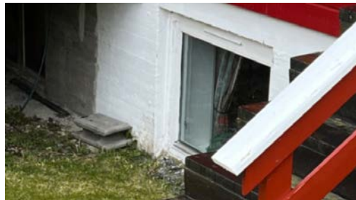
Vindu ligger for nært terrenget
