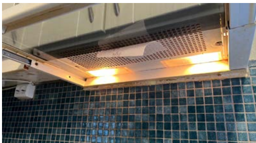
Kjøkkenventilator er funksjonstestet
