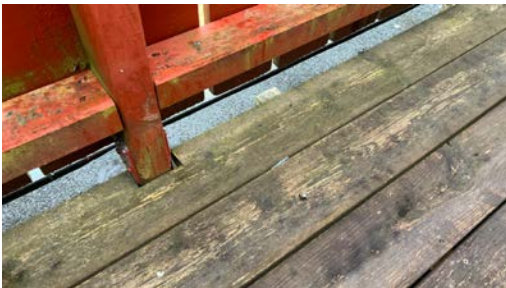
Værslitasje og sprekker i treverk på veranda mot vest
