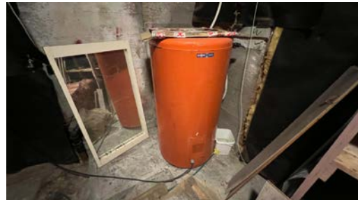
Varmtvannstank på ca. 200 l
