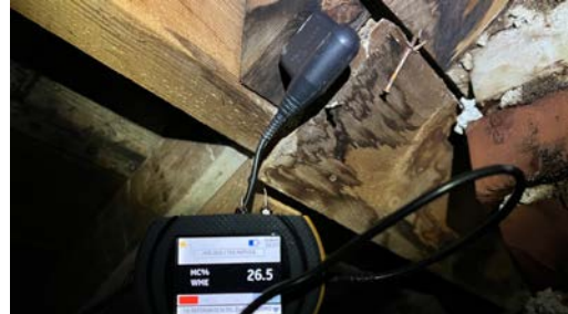
Fukt i treverk rundt pipen
