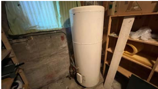
Varmtvannstank på ca. 300 l
