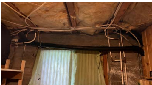
Synlige vannrør og avløpsrør i underetasjen
