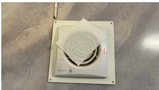
Avtrekk er funksjonstestet
