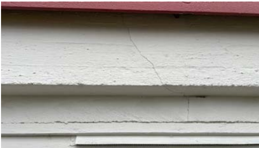
Sprekk i murever vindu
