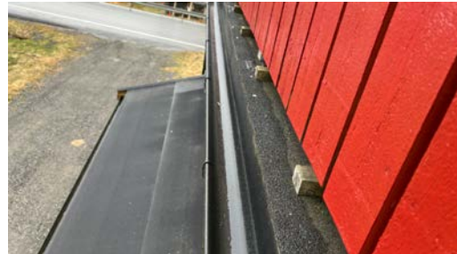
Membran av takpapp på veranda i 2. etasje
