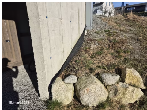
Bildet viser grunnmursplast som ikke er kappet, og topplst mangler.
