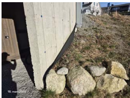
Bildet viser grunnmursplast som ikke er kappet, og topplist mangler.
